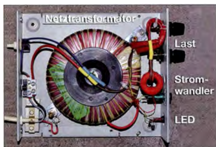
Bild 1: Gehäuse des Netztransformators mit integriertem Stromwandler Foto: Mader
