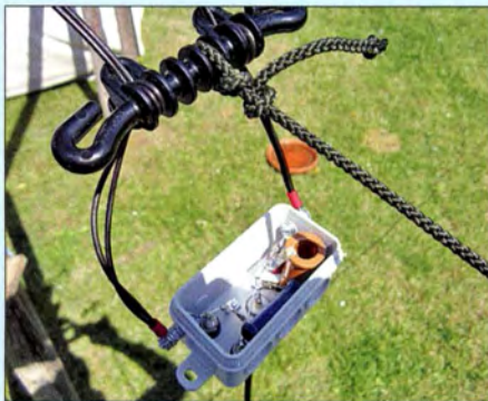
Bild 7: Geöffnete Einspeisebox an der Zweidraht-Speiseleitung (zugentlastet durch einen Dipol-Mittenisolator)
